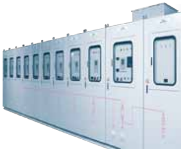
配電盤 SWITCHGEAR & CONTROLGEAR
