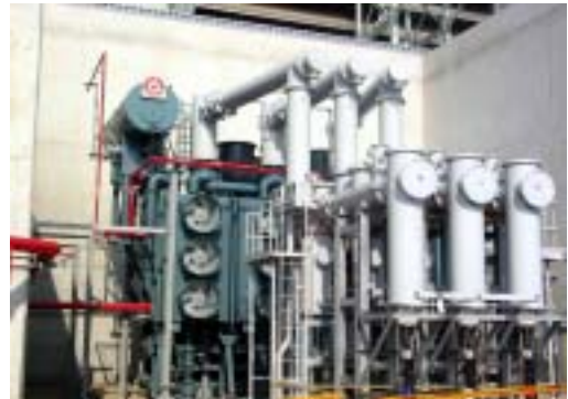
台電大潭電廠火力發電用變壓器 345kV-340MVA
