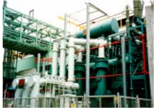
台電興達電廠火力發電用變壓器 345kV-330MVA
