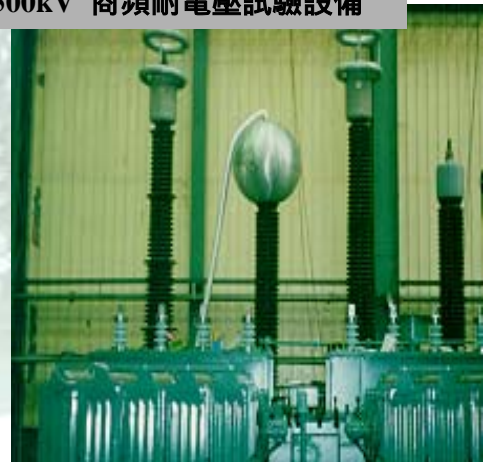
500kV 商頻耐電壓試驗設備
