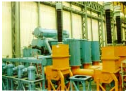
台電明潭電廠水力發電用變壓器 345kV-300MVA
