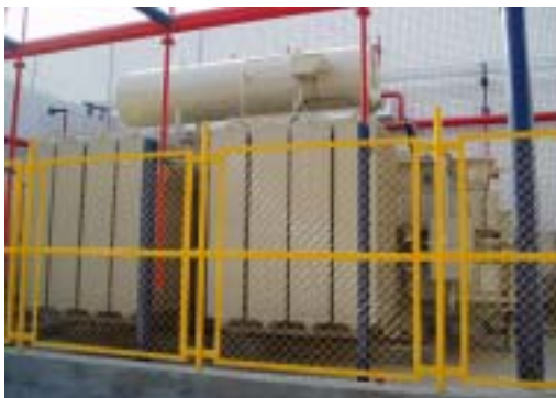
大陸台化寧波熱電公司變壓器 110kV-100MVA
