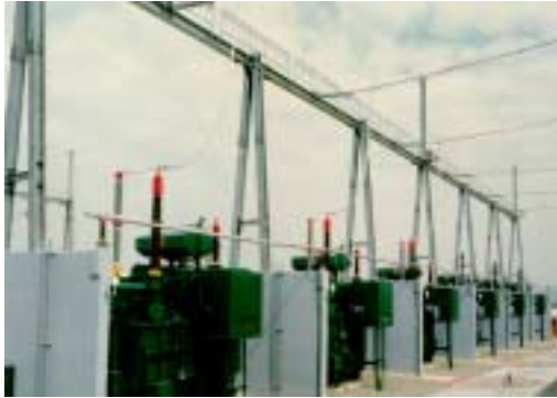
台電公司超高壓自耦變壓器 345kV-500MVA
