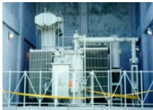
台灣塑膠公司汽電共生用變壓器 161kV-150MVA
