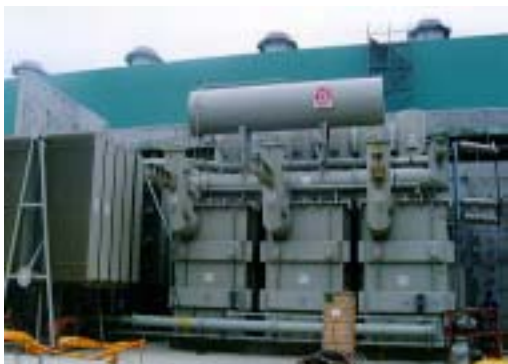
民營電廠長生電力發電用變壓器 166kV-386MVA
