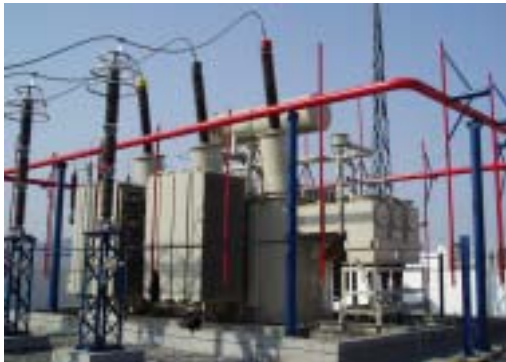
大陸台化寧波熱電公司變壓器 236kV-150MVA
